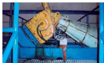
Přerušovací komora Bílov
