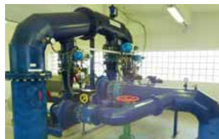
Úpravní vody Vyšní Lhoty
