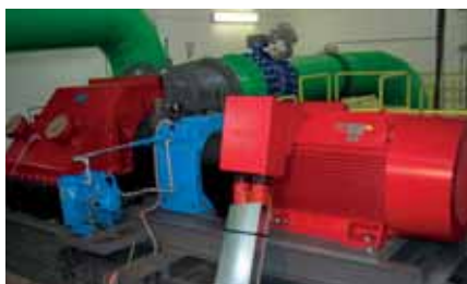
Úpravní vody Podhradí
